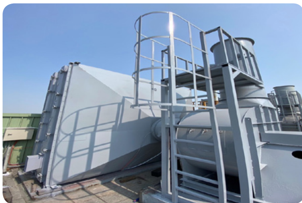
空污防制設備
