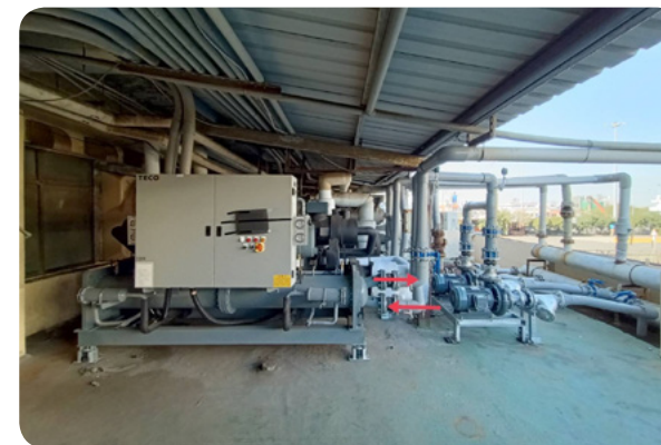
安平 80RT 冰水主機
