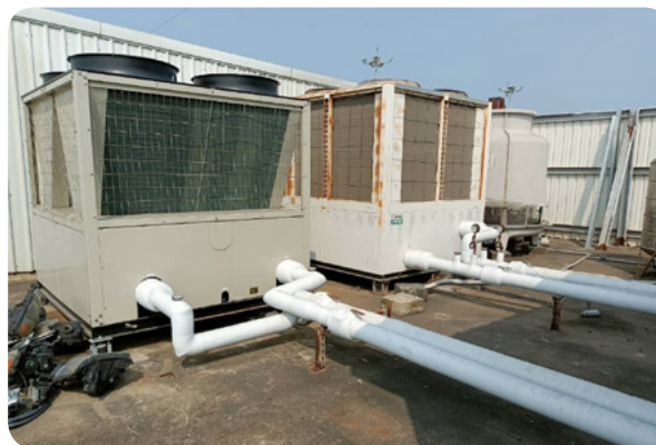
安平 40RT 冰水主機
