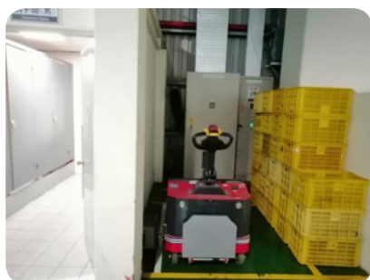
科三廠 OEM 物料區裝設偵煙器
