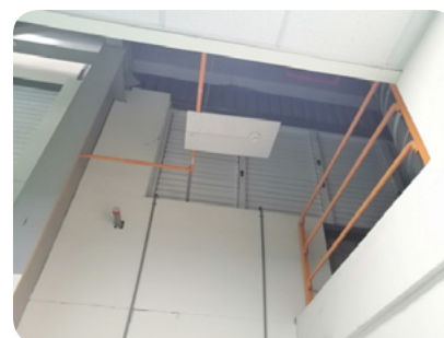
科三廠 OEM 物料區裝設偵煙器
